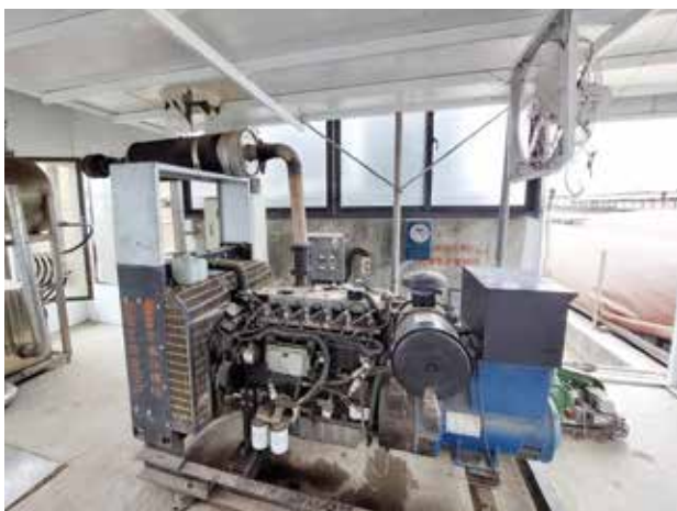
▲A 畜牧場沼氣發電設備。
