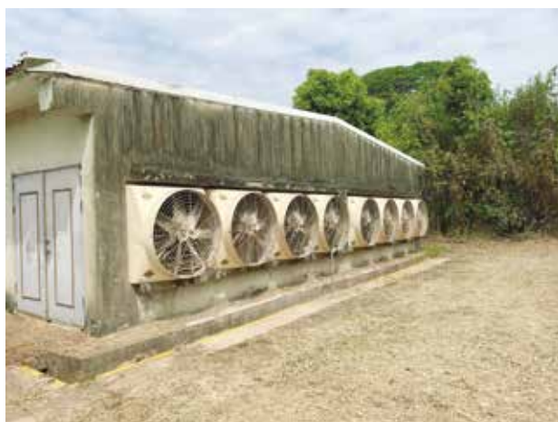
▲ 蛋雞舍改善後變頻負壓風扇。
