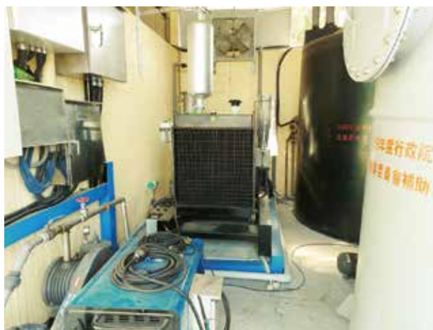
▲B 畜牧場沼氣發電設備。
