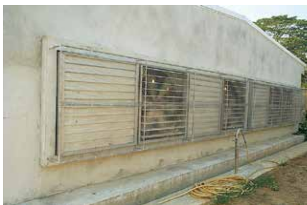
▲ 蛋雞舍改善前原定頻負壓風扇。
